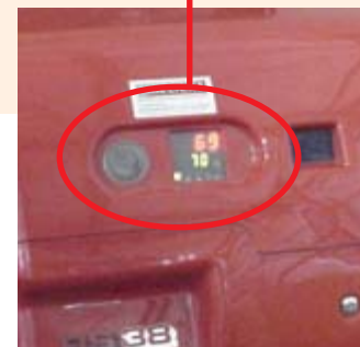
Sistema di impostazione automatica della temperatura del fluido riscaldante.
