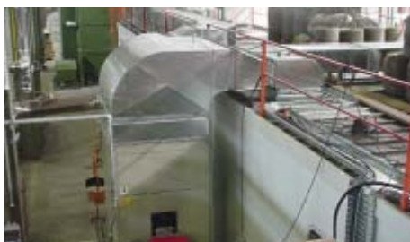
Impianto aspirazione linea lana di vetro.
