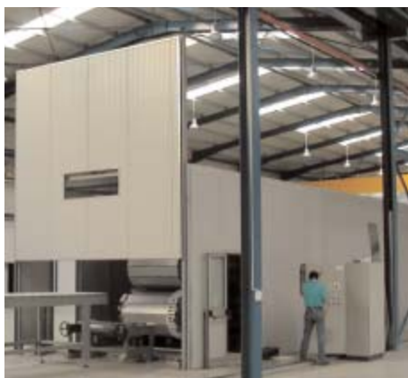
Impianto di aspirazione zona schiumatura.
